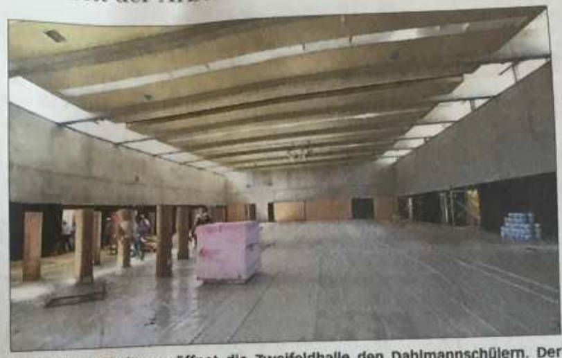
Neue Möglichkeiten eröffnet die Zweifelhalle den Dahlmannschülern. Der Boden ist schon verlegt, wird aber durch Folie geschützt. Fotos: Ruffer
