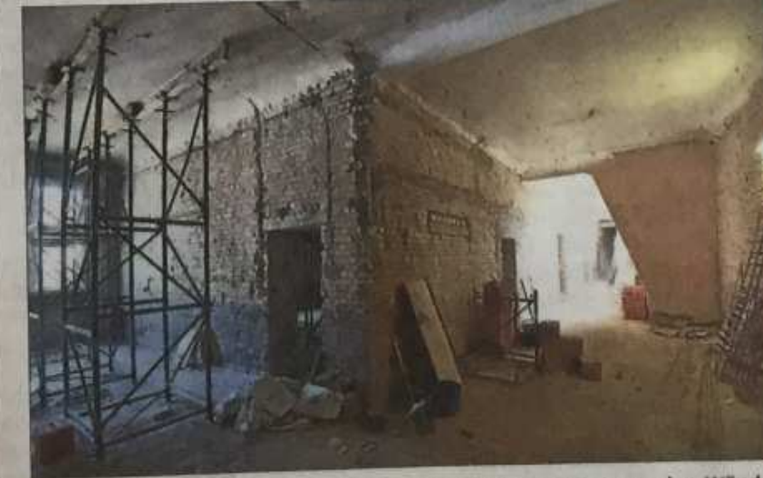
Auf den Kopf gestellt wird die Elisabethenschule: Der Putz an den Wänden ist abgeklöpft, Träger stützen die neu gegossene Betondecke.
