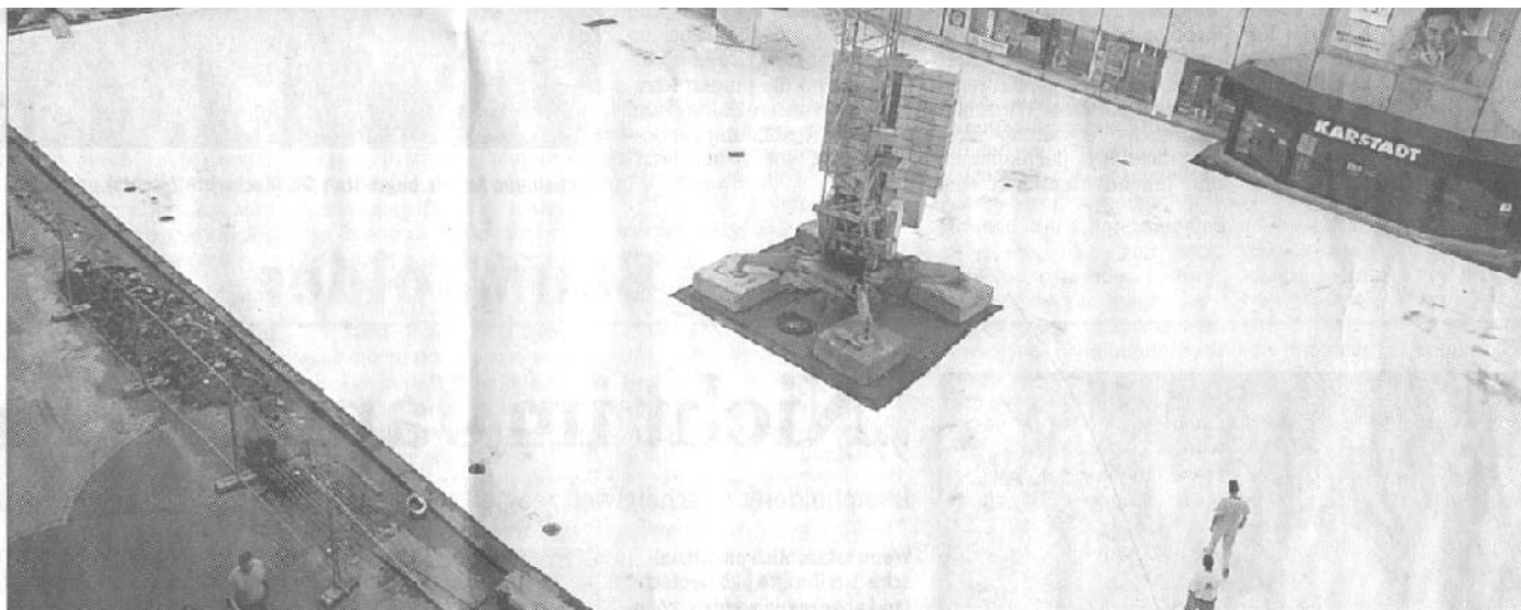
Kein Eisstadion, sondern eine Baustelle im Ruhezustand: Auf dem Platz Auf der Idar geht es trotz Zeitnot nicht weiter. ■ Foto: Hossler
