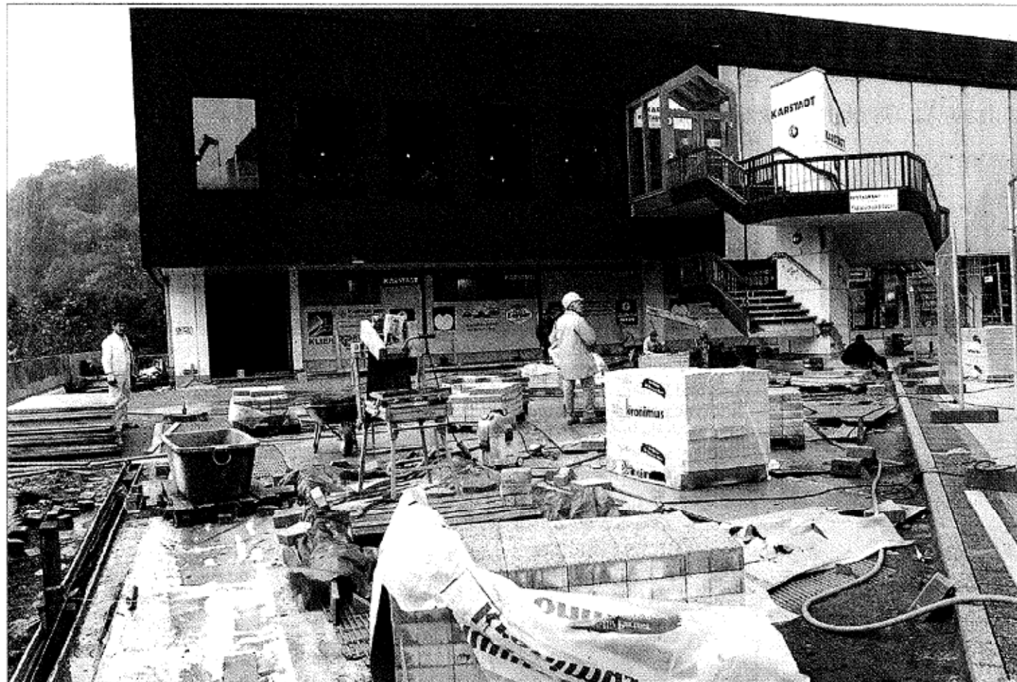
„Keine Baustelle, sondern ein Sauhaufen“ – Architekt und Bauleiter Jörg Bill benutzte deutliches Vokabular, als er dem städtischen Bauausschuss eine aktuelle Lagebeschreibung zur Baustelle Auf der Idar gab. ■ Foto: Hosser
