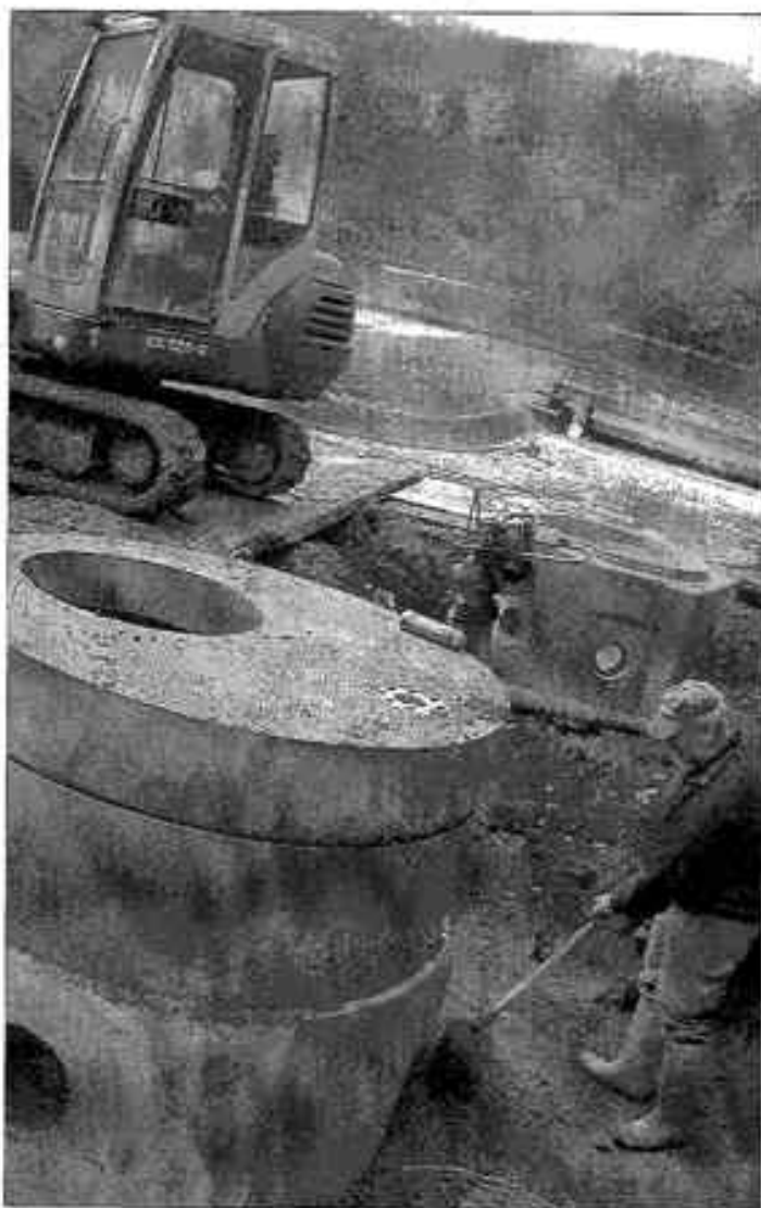
Rund zweieinhalb Monate soll die technische Erneuerung der Kläranlage in Frauenberg dauern. ■ Foto: Michael Werle
