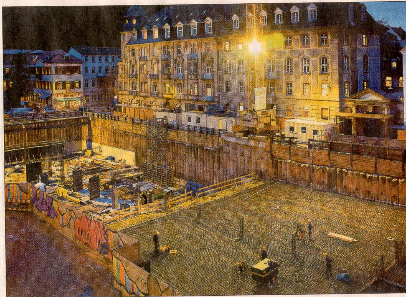
Von morgens 7 bis teilweise 12 Uhr in der Nacht wird momentan am Friedrich-Ebert-Platz gebaut, und das Areal in den Abendstunden kräftig ausgeleuchtet. Über die Hälfte des Tiefgaragen-Rohbaus ist schon abgeschlossen. Damit liegt man voll und ganz im Zeitplan, ab Mitte des kommenden Jahres soll die fertige Garage Platz für 256 Autos bieten. Foto: joe
