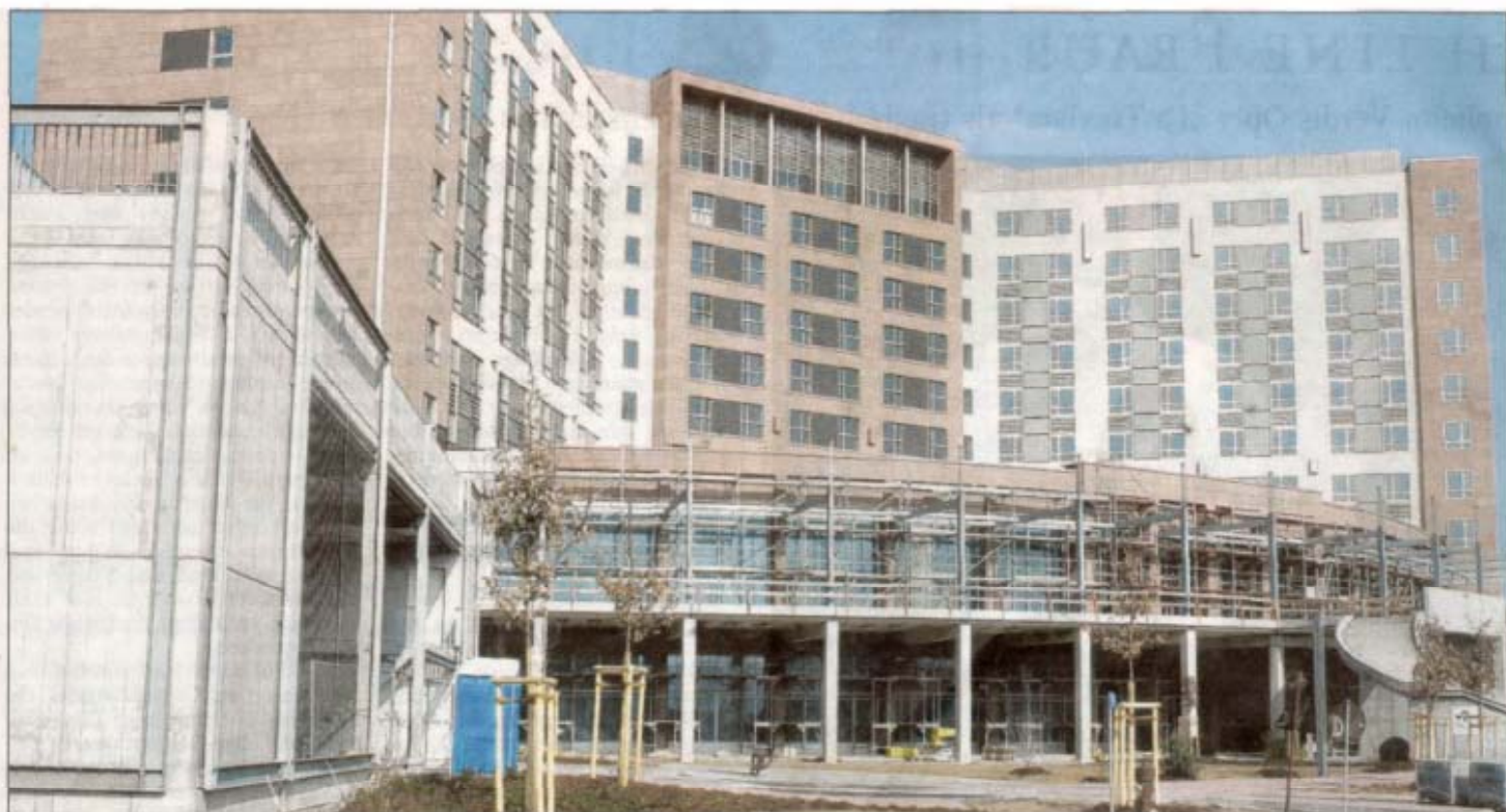
Zwar gab es einen Baufortschritt, viel hat sich seit diesem Bild vom März aber nicht geändert: das KMCC auf dem Flugplatz Ramstein. — ARCHIVFOTO: VIEW
