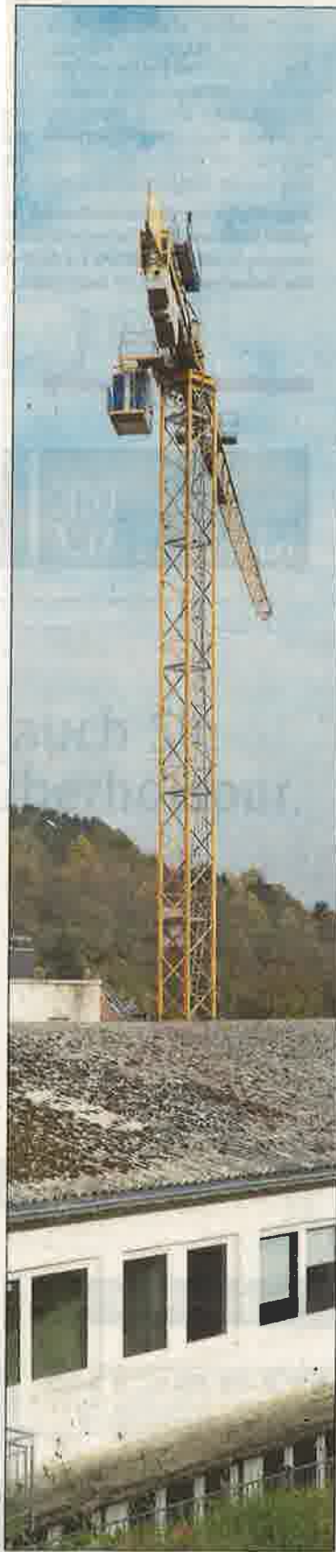
Sorgt für reichlich Spekulationen: der Kran, den die Firma Budau in der Kuseler Innenstadt aufgestellt hat.
