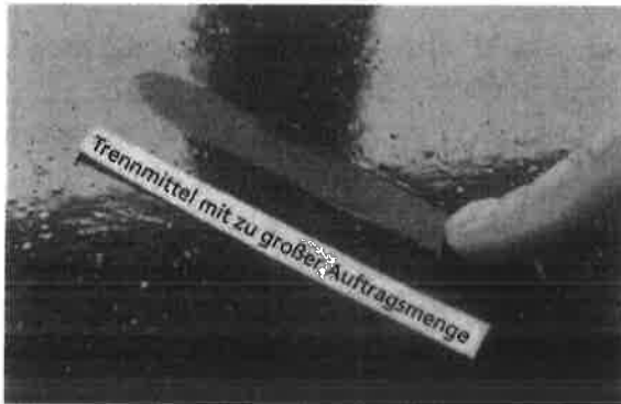
Bild F.3. Schalungshaut mit unterschiedlichen Auftragsmengen, zu große Auftragsmenge (aus [20])
